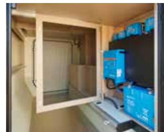
Garage avec centrale de commande électronique
